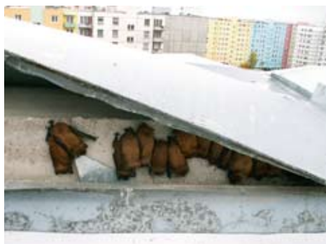
Zimující netopýři rezaří pod plechem střechy panelového domu, objevení při zateplovacích pracích foto. R. Lučan
