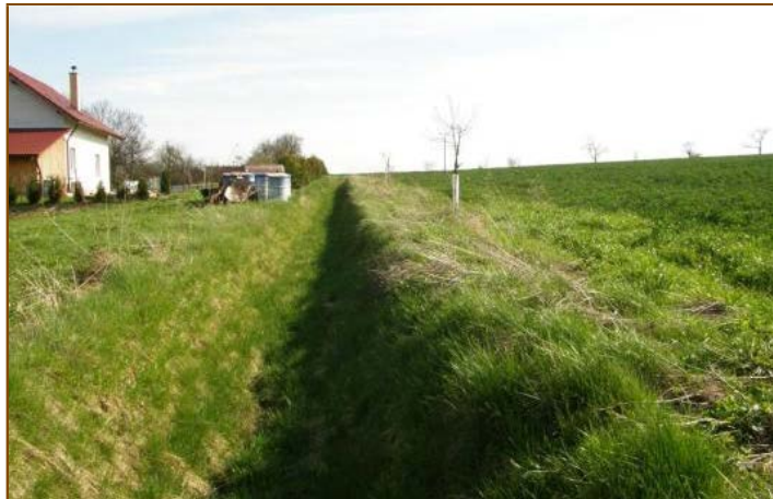
Obr. 4-17: Protierozní zachytň příkop (Rašovice u Uhliřských Janovic, foto VÚMOP, v.v.i.). Díky valu, vzniklému nad příkopem nesprávnou údržbou se voda nemůže dostat do příkopu a teče paralelně po poli.
