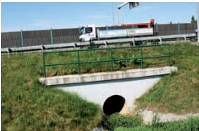
Obr. 6: Kombinace neprůchodného propustku a protihlukové stěny
