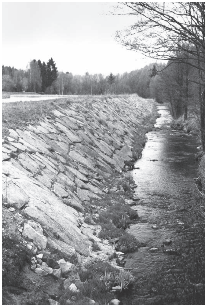
Postranní nádrž – dlouhá a masivní boční hráz je nákladná a představuje v krajině problematický, cizorodý objekt. Kontakt vodního toku s patou hráze představuje trvalé technicko-bezpečnostní riziko.
