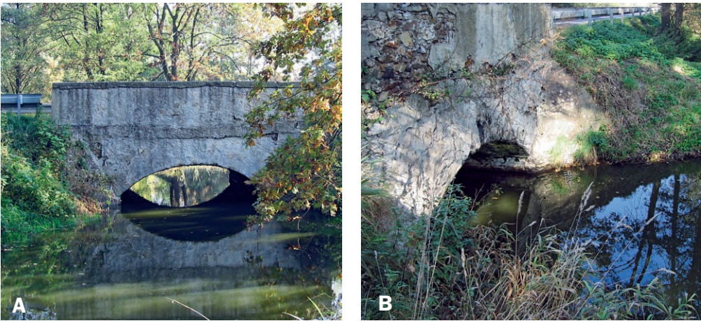
28. Fotografie špatně průchodného mostu na Zlaté stoce.
