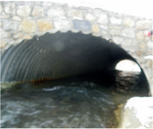
31. Detail nevhodujícího mostu přes Hamerský potok.
